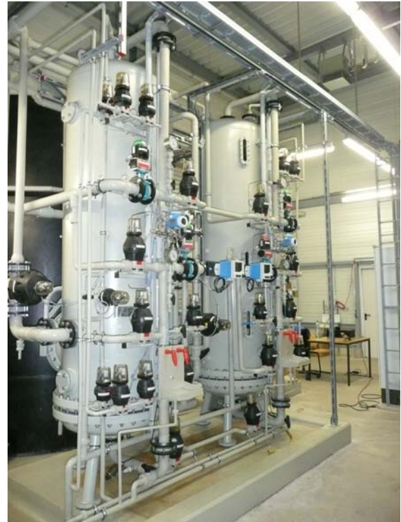
Demineralisation line 45 m³/h
