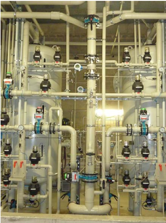
Demineralisation line 20 m³/h
